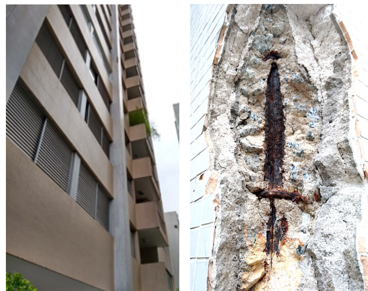
Figura 6.3 Fissuras e deslocamentos do revestimento e do concreto em pilar principal de edificação residencial em São Paulo (Fonte: MARTINS, 2019)
